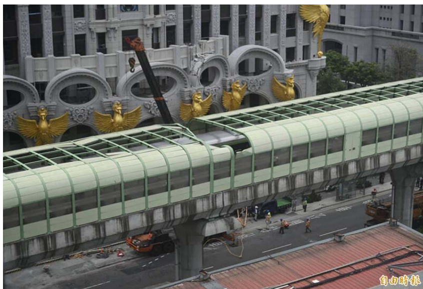
台中捷運10日發生重大工安意外事件，造成1死9傷。
